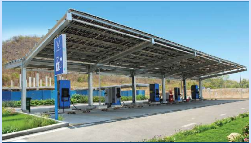
Trạm dừng nghỉ Vinh Hảo - Phan Thiết (Km 205), Công ty TTC Châu Thành đã triển khai lắp đặt đưa vào hoạt động trạm bên phải tuyến 7 trụ sạc (tương đương 14 vị trí bãi đỗ xe vào sạc điện) và trạm bên trái tuyến 6 trụ sạc (tương đương 12 vị trí).
